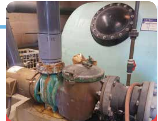
Las tuberías necesitan reemplazarse
