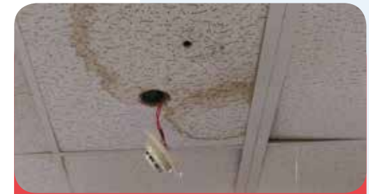
Techos con goteras necesitan reparaciones
